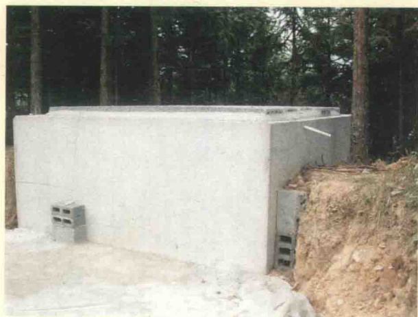
村级饮用水蓄水池
