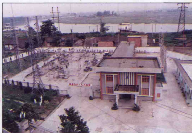
玉阳 30 千伏变电站
