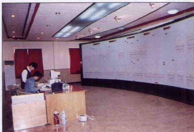
公司电力调度室
