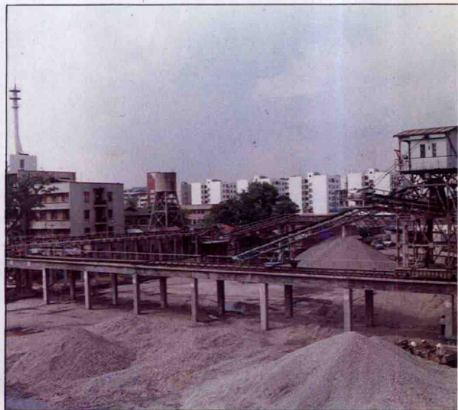
高架皮带运输线
