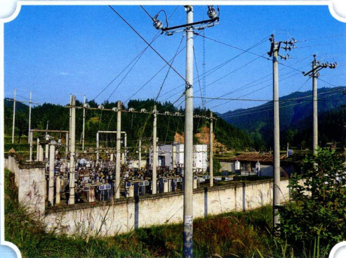
启蒙35KV变电站 (付彬/摄)
