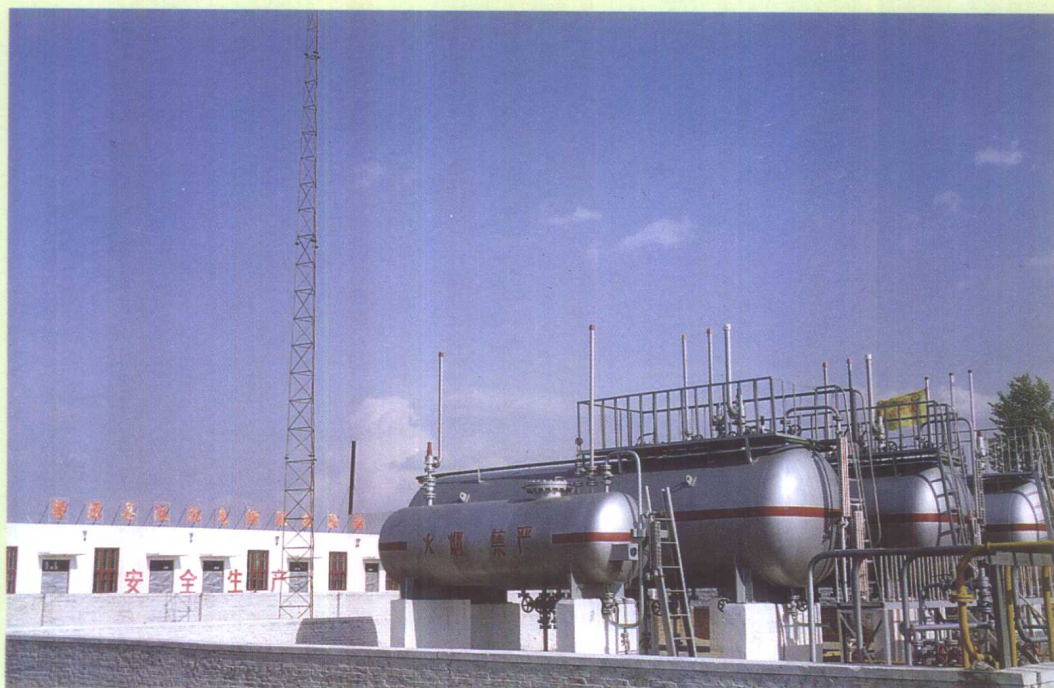
源庆液化气有限责任公司液化气储备罐
