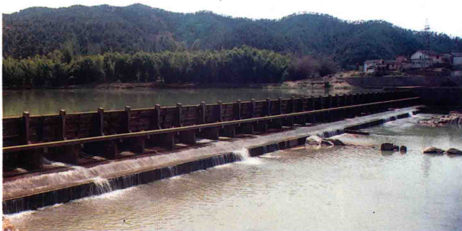
大埔曲滩水电站翻板闸
