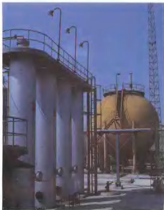
硅钢事业部建成煤气提氢装置
