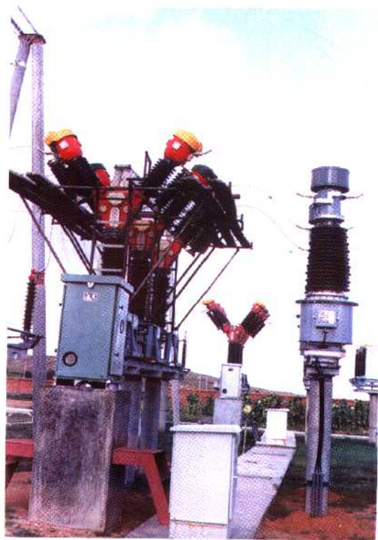
化德县二〇千伏输变电站一角
