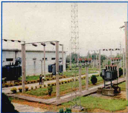
△陈营镇变电站一景
