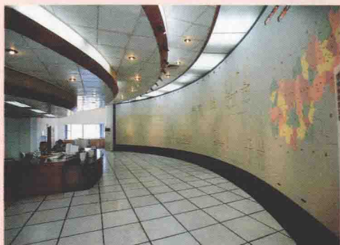
◀ 220 千伏青云变电所主控室
