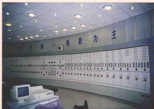
▲市供电局调度室
