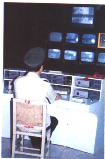
← 中国工商银行尤溪县支行 设有电视监控室,每天记录下 营业厅活动情况,有效地防范 案件、差错的发生。
