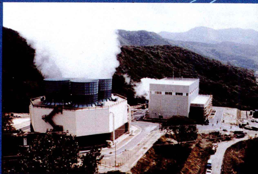
地熱発電 白煙の出ている部分が冷却タワー。出力5万kwで運転されている。(北海道・森川) 写真/北海道電力
