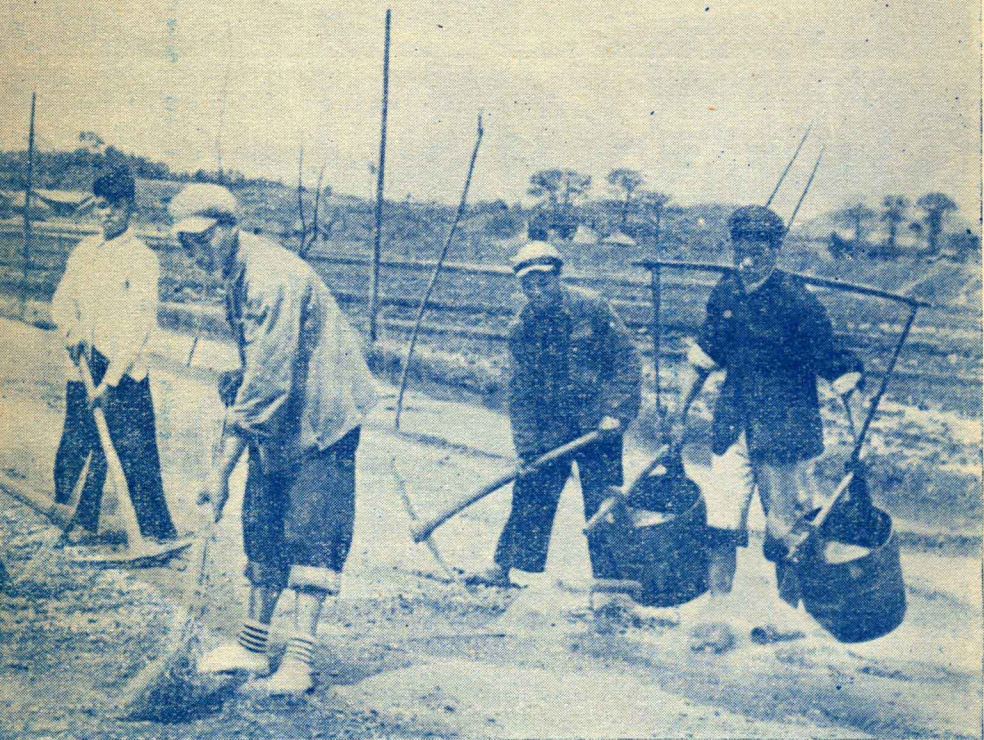
3.發現路面有坑槽時立即修補。
