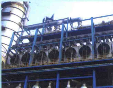
石化——广石化增压脱硫装置
