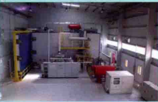
煤油气相干燥设备-特高压变压器真空干燥
