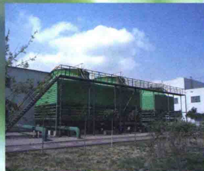
冷却循环水——西宁特钢水处理
