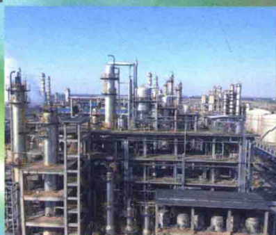
化工——萧山恒逸己内酰胺装置
