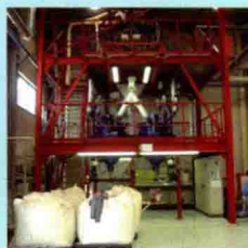
混料站系统-APG压力凝胶设备 提供混合料
