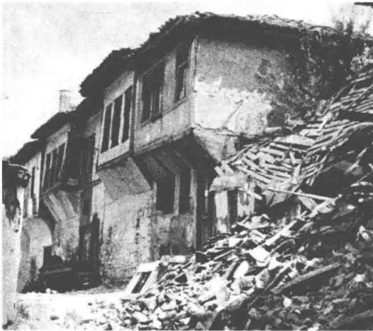
图 1.6 左侧木结构轻微损坏，右侧石砌结构完全倒塌
