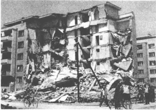
图 1.4 5层石砌建筑的右侧倒塌
