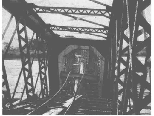
图1-1-2 浓尾地震中损毁的钢桁架桥
