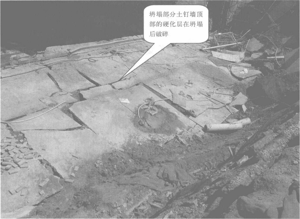
图 1-9 已坍塌土钉墙的顶部情况
