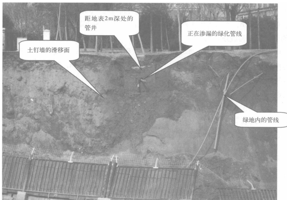
图 1-7 坍塌正中部位暴露出的绿化管沟及管线
