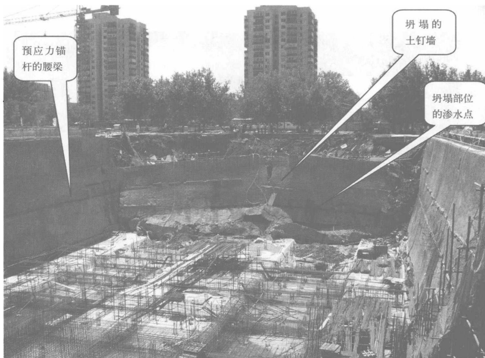
图 1-8 基坑西侧坍塌土钉墙的立面
