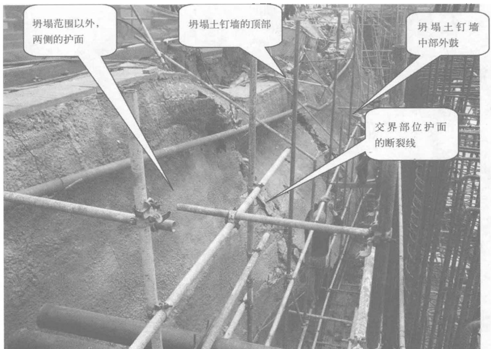
图 1-12 坍塌边界处土钉墙护面断裂破坏情况
