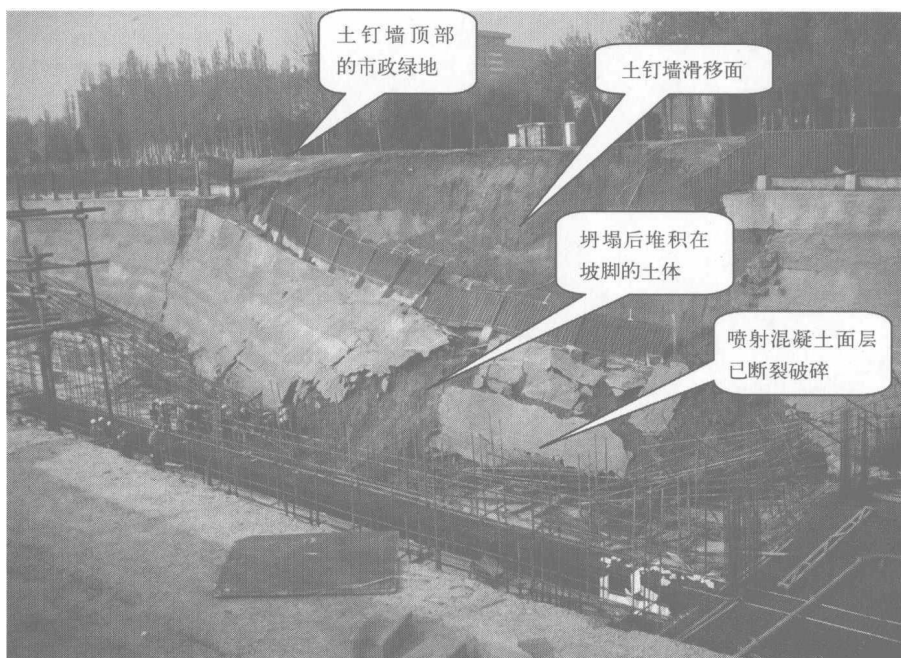
图 1-3 坍塌土钉墙的立面
