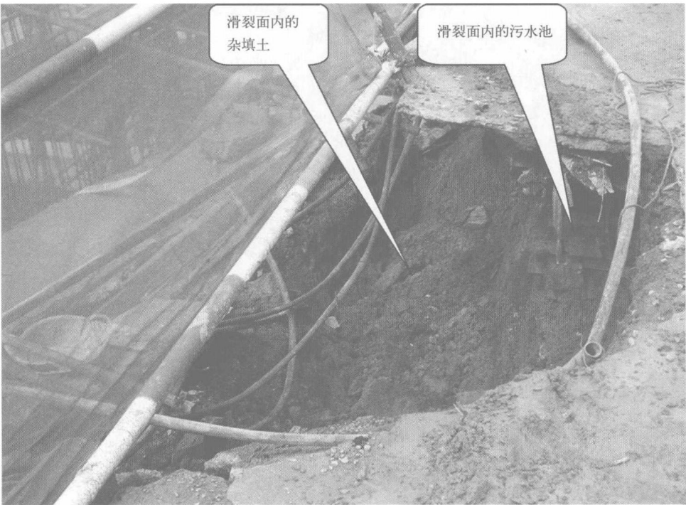
图 1-15 滑裂面处暴露的杂填土及污水池
