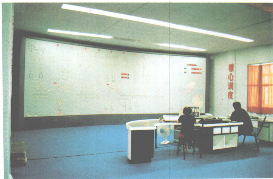
黔东南州地方电力总公司湄阳河供电公司镇远调度所中心调度室
