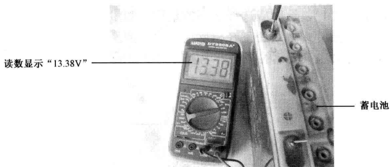
图1-39 直流电压测量
