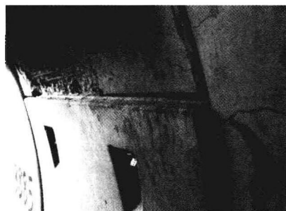
图 1-8 管片衬砌的开裂、错台现象
