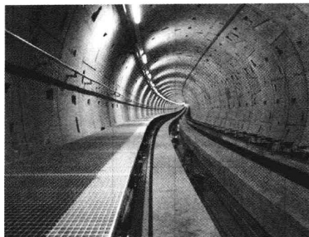
图 1-7 拼装后的钢筋混凝土管片衬砌
