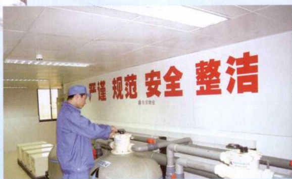
精心维护，保证设备正常运行
