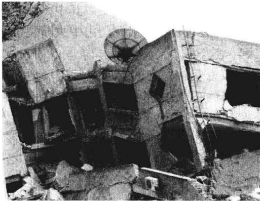
图 0-15 汶川地震中倒塌的框架结构房屋
