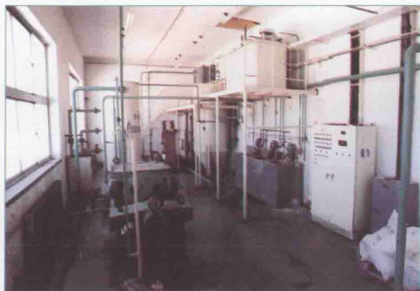
大连三井森 包装有限公司印 刷废水处理工程
