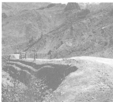
图 1.9 路基沉陷段边坡
