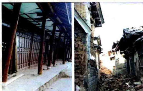
▲ 地震中受损的房屋
