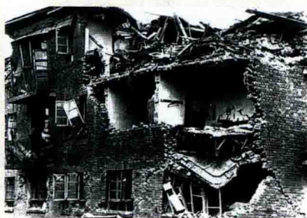
▲ 唐山地震中损坏的房屋
