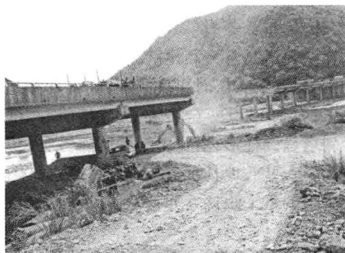
图 1.6 浙江某桥梁溶洞桩基塌陷
