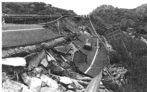
图 1.5 福建罗长高速公路路基坍塌
