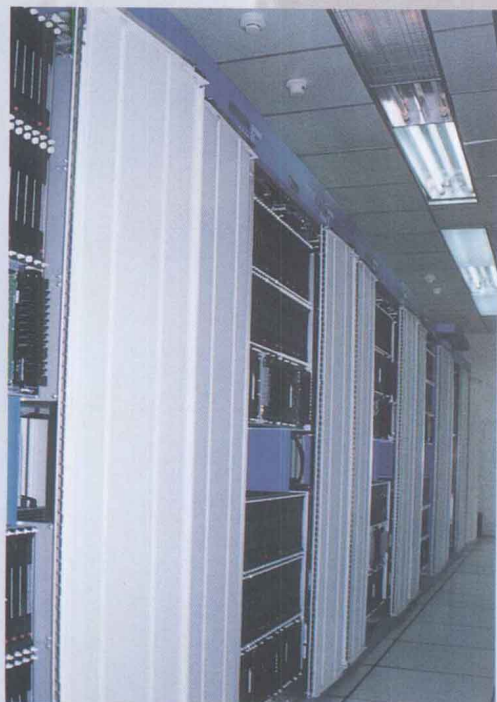
程控电话机房
