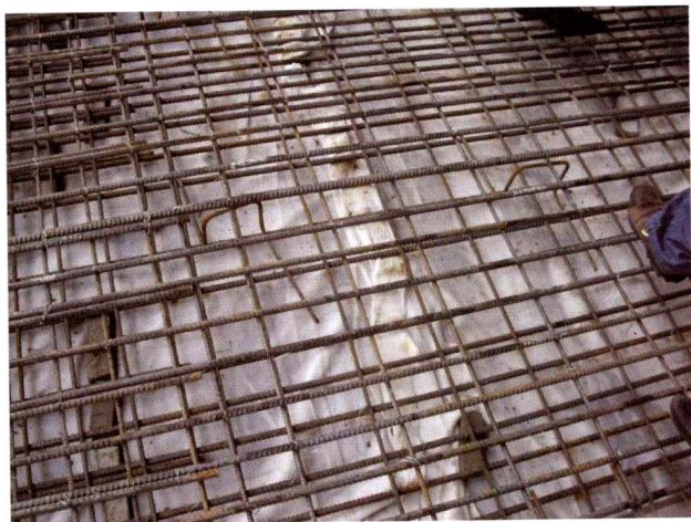
图 3.2.1—5 土工膜折痕、不平整
