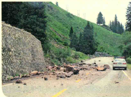
落石塌方随处可见
