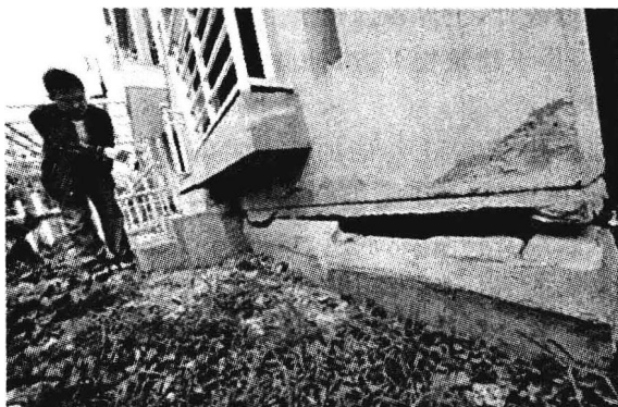
图 0.5 某小区地基沉降造成墙底裂缝
