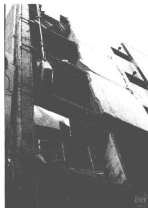
图 1-16 外围墙板脱落
