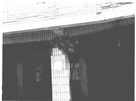
图 1-12 钢筋混凝土柱酥裂
