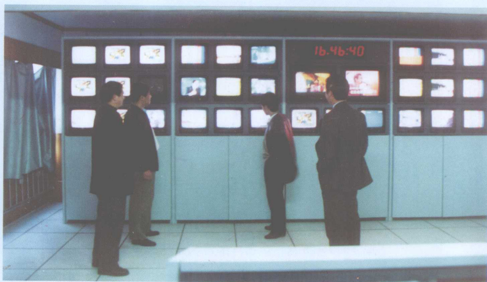
▶ 毕节地区有线 电视台机房
