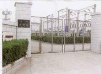
■ 第一座35千伏铜井变电站
