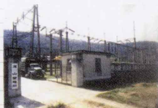
■ 第一座220千伏龙山变电站
