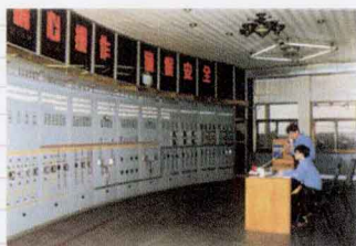
■ 第一座110千伏天井山变电站
