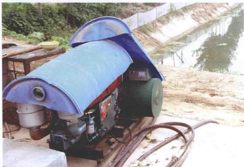
■ 养殖场发电设备
