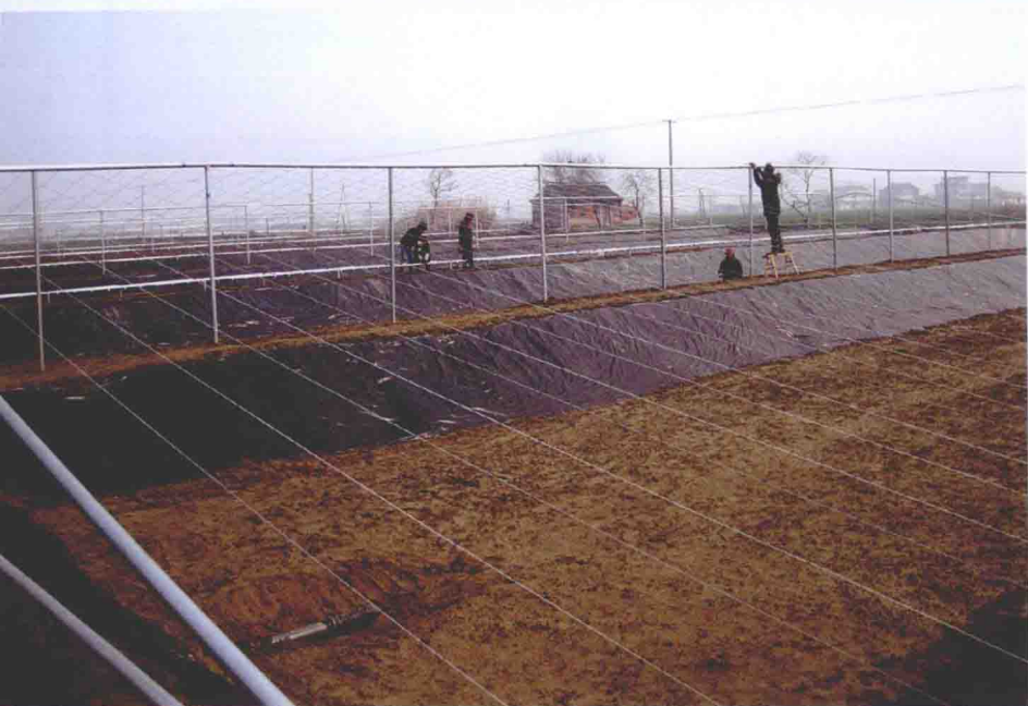
■ 鱼塘微孔管道增氧设施
