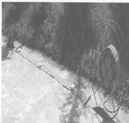
图5 低压管道输水灌溉田间闸管系统成套设备及连接技术
