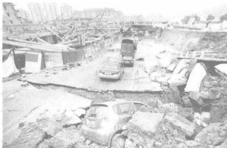
图 1-18 杭州地铁坍塌事故
