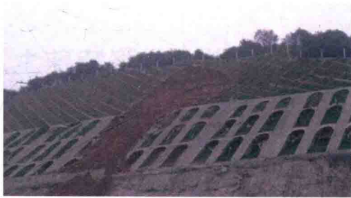
图 1.5 贵州红黏土边坡坍塌
