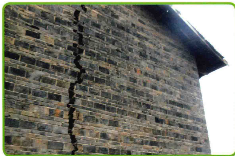
滑坡导致的房屋开裂
