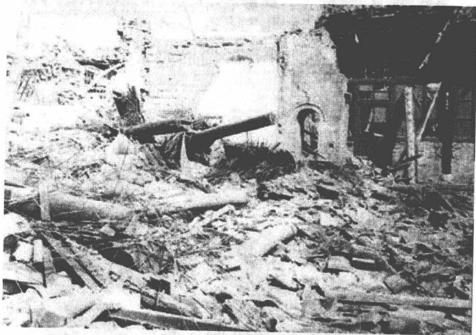
图1-1 邢台地震中倒塌的房屋
