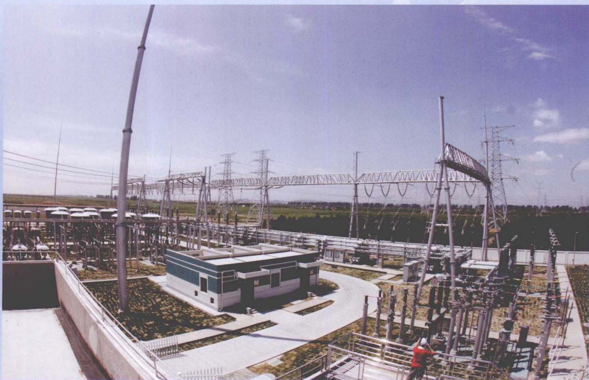
投运于2009年7月的宁波电网第五座500千伏变电所——句章变电所
