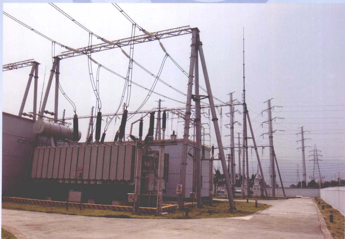
投运于2009年12月的宁波电网第一座220千伏程序化变电所——梨洲变电所
