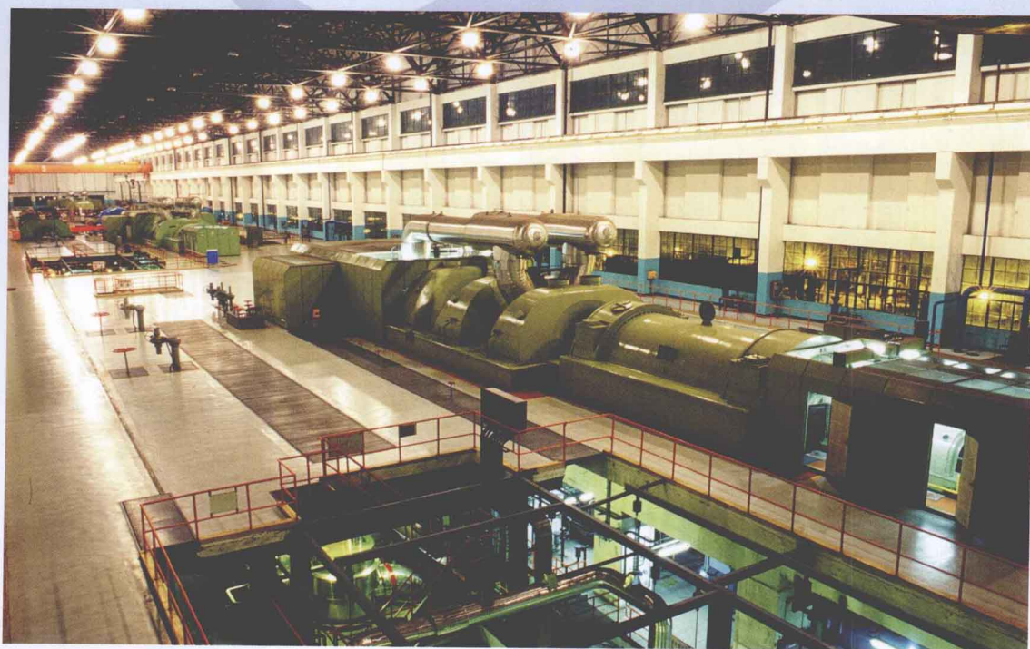
镇海发电厂主厂房内景
