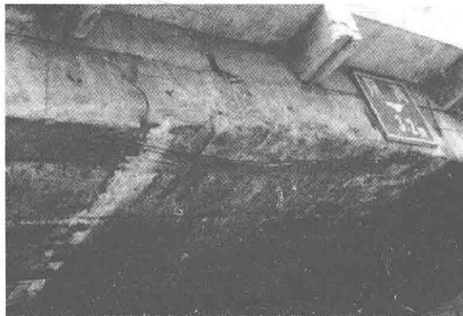
b) 使用期间车辆超高导致主梁严重损伤
