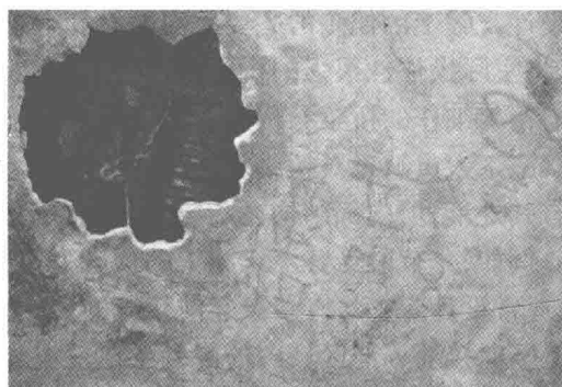
b) 钢筋及波纹管下的混凝土空洞缺陷
