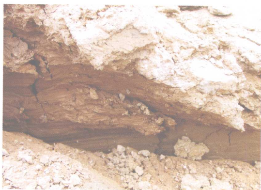
法院后滑坡失稳时的侧缘剪裂面
