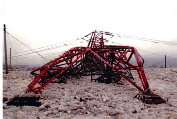
图1-12 雪灾中因失稳而倒塌的电缆塔
