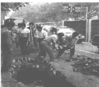
图 1-6 南京地铁隧道工程事故
