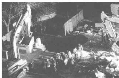
图1-2 北京地铁隧道工程事故
