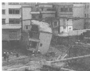
图 1-5 广州地铁隧道工程事故
