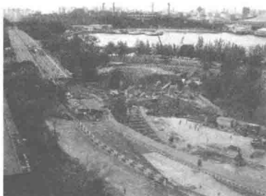
图 1-4 新加坡地铁隧道工程事故
