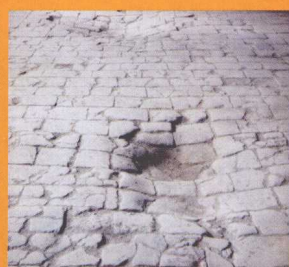
武僧脚坑（局部）
