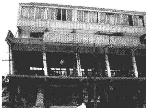
图 1-10 框架强梁弱柱破坏
