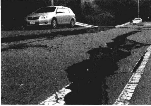
图 1-3 日本 9 级大地震公路路面开裂
