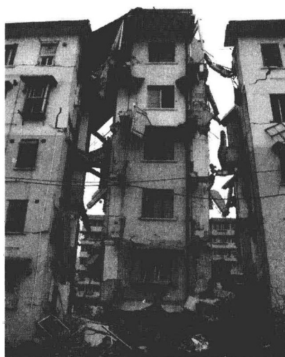
b)房屋中部薄弱部位倒塌
