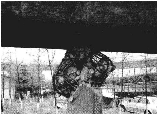
图 1-7 高速路桥墩破坏
