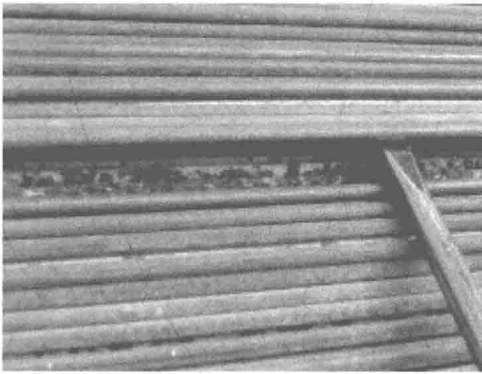
图 1.6 东缆中跨表面附近腐蚀情况 (Stage 4)
