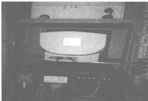
图 1-2 老旧故障录波器工控主机图
