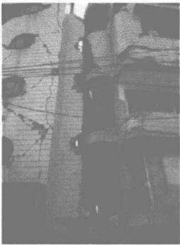
(b) 8 度区某相邻建筑地震中相互碰撞，损坏严重
