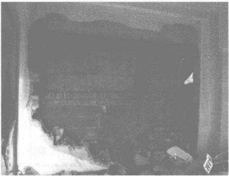
(a) 抗震缝宽度不够，相邻两栋建筑地震时相互碰撞，导致其中一栋建筑的填充墙倒塌
