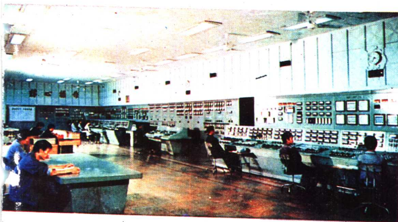
焦作电厂总控制室。
